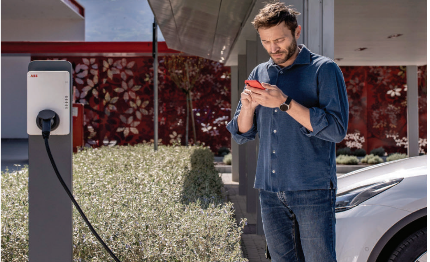
Şekil-7: Elektrikli araç şarj istasyonu
